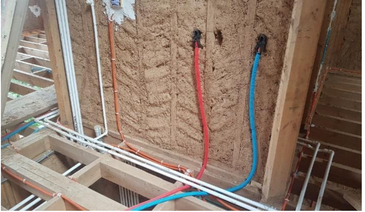
Şekil 11. Döşemeden ve duvardan geçen tesisat boruları
