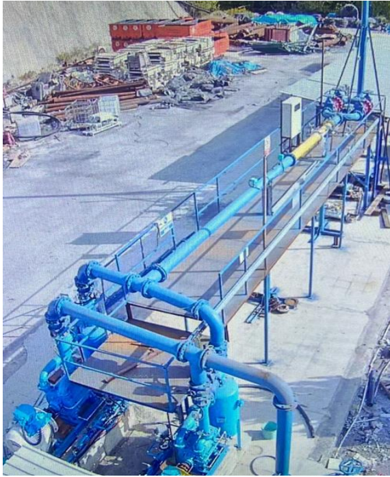
Şekil 17. Yerüstünde kurulmuş metan drenaj pompası.
