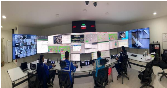
Şekil 6. Yerüstü gaz izleme merkezi.
