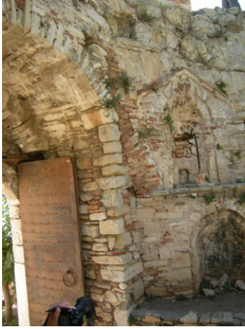
Resim 20: Ana giriş kapısının gerisindeki tamir izleri.
