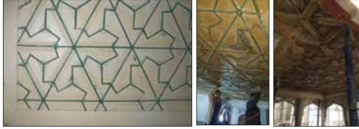
Görsel 7. Muezzin mahfilinin restorasyon öncesi durumu (İstanbul Vakıflar I. Bölge Müdürlüğü).
