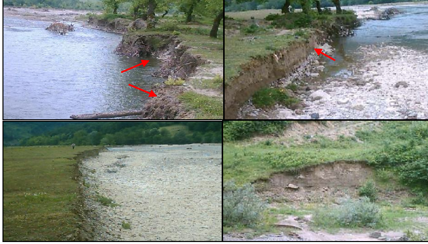
Şekil 4. Taşkın sahaları üzerinde gözlenen kıyı oyulmaları.
