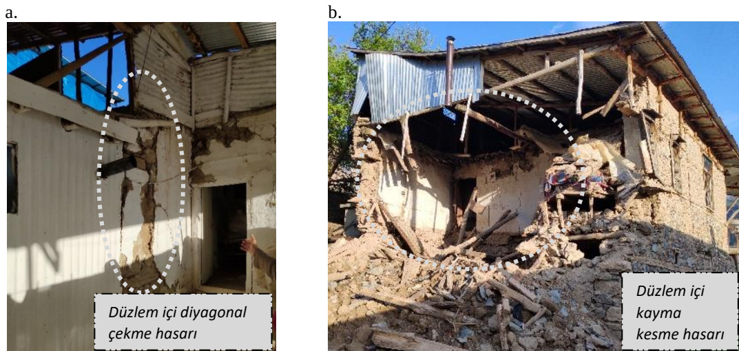
Şekil 9. Düzlem İçi Davranışa Bağlı Hasarlar
