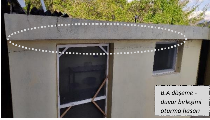
Şekil 13 (devam). Farklı Zemin Oturmalarına Bağlı Hasarlar
