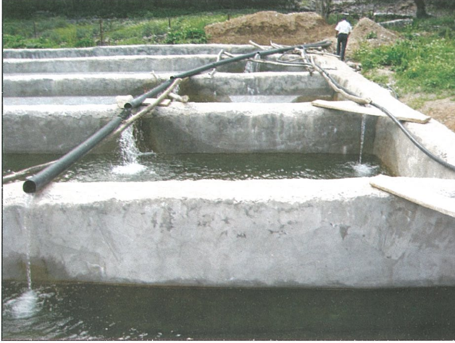
Şekil 1. Çatak-Elmacı 1 tesisi, havuzlara hatalı su girişi
