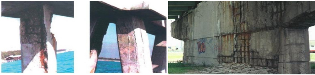
Şekil 4. BOTAŞ petrol platformunda meydana gelen yapısal hasarlar ve diğer bazı köprü ayaklarındaki hasarlara örnekler [4]
