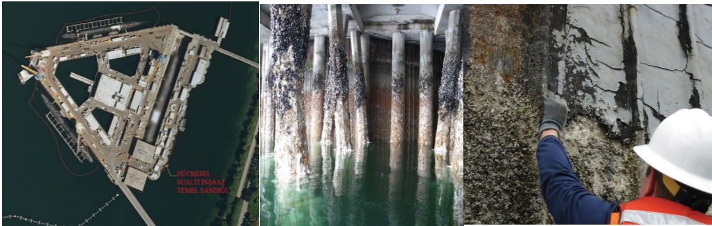
Şekil 8. Denize yakın ortamlarda korozyon hasarları [7]
