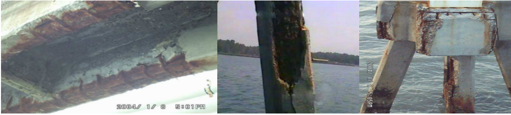
Şekil 5. BOTAŞ petrol platformunda korozyon kaynaklı meydana gelen yapısal hasarlar [4]
