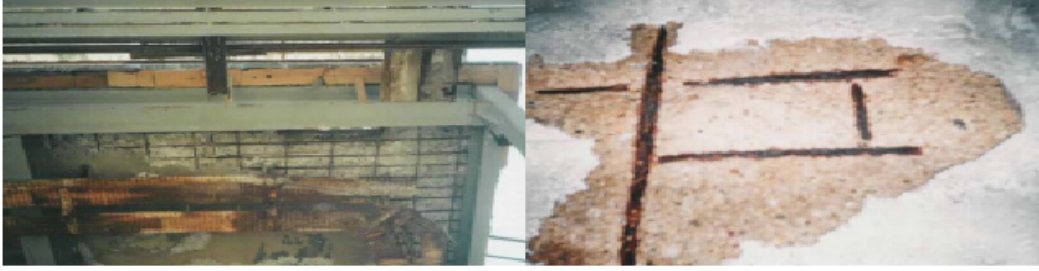
Şekil 7. Denize yakın ortamlarda korozyon hasarları [6]
