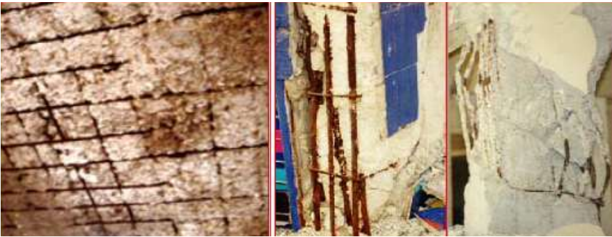
Şekil 5. Korozyona uğramış yapı elemanları örnekleri (Doğan (2009)).
