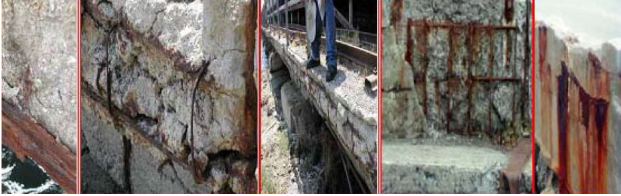
Şekil 3. Deniz kenarında korozyona uğramış yapı örnekleri (Doğan (2009)).
