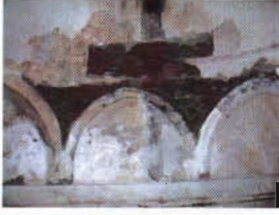
Resim 19: Soyunmalık bölümünün eski sıvaları
