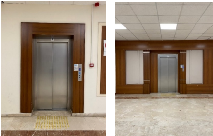
Kütüphane binası asansörleri
