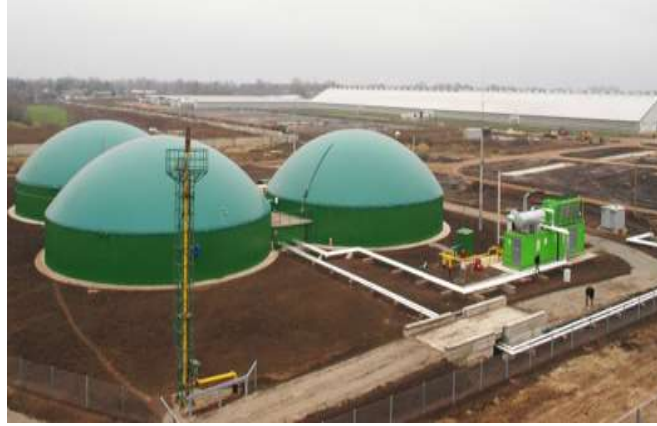
Şekil 6. Biyogaz üretim tesisi
