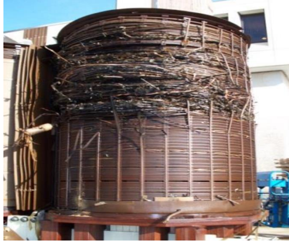
Şekil 1. Güç transformatörü sargısındaki bozulma
