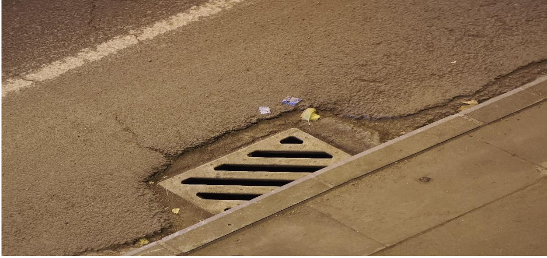
Şekil 9. Su tahliyesi yapılmaması sonucu oluşan tahribat
