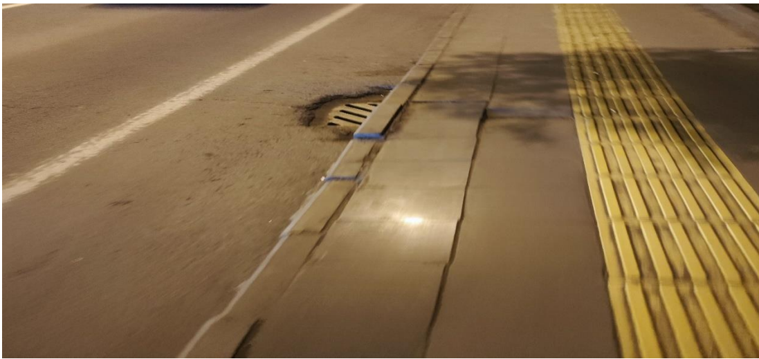
Şekil 10. Mevcut yolda yetersiz yağmur suyu giriş ızgarası
