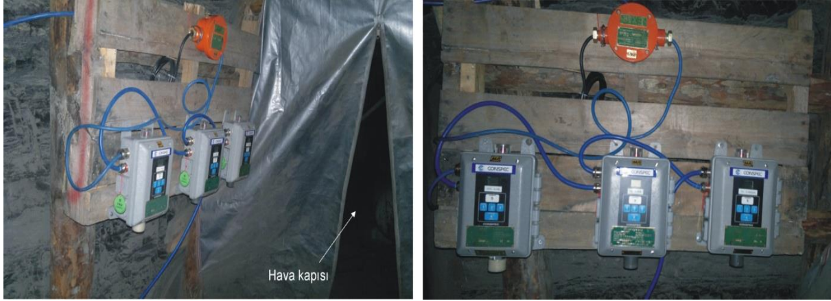
Şekil 1. Hava dönüş galerisi üzerindeki gaz izleme istasyonu
