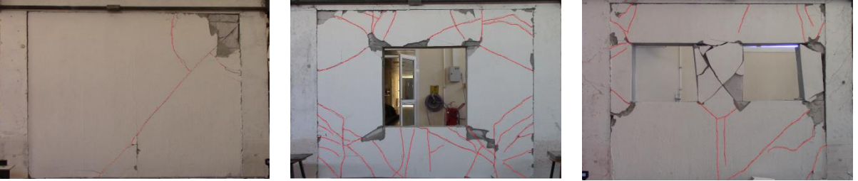
Şekil 11. %3,5 ötelenme oranında, dolgu duvarlarda meydana gelen hasarlar.
