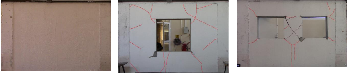
Şekil 10. %1 ötelenme oranında, dolgu duvarlarda meydana gelen hasarlar.
