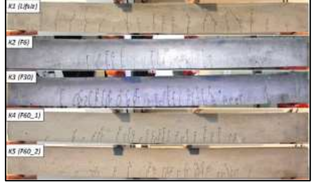
Şekil 14. Kirişlerin akma yerdeğiştirmesine ait çatlak dağılımı
