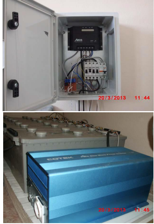
Şekil 3. Şarj ünitesi, sigortalar, akümülatörler ve inverter.
