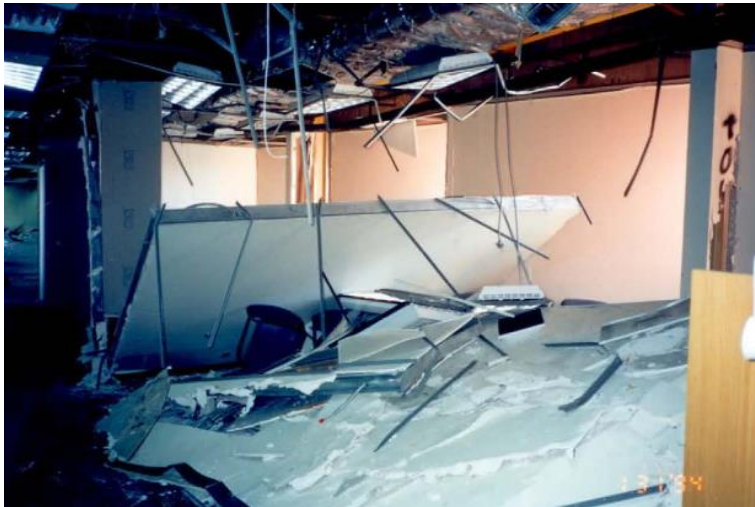
Şekil 3. Deprem sonrası devrilmiş bölme duvar
