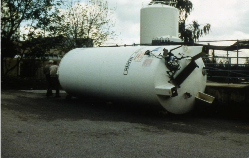
Şekil 6. Yetersiz bağlantı elemanları sonucu devrilmiş tank
