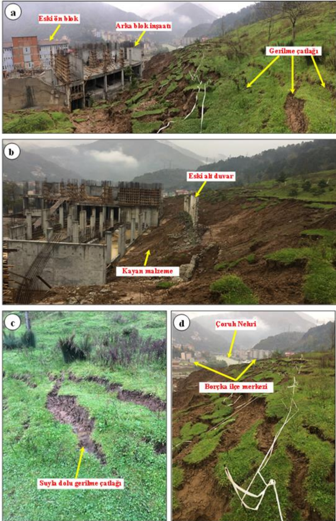
Şekil 3. Zemin şevinde meydana gelen gerilme çatlakları
