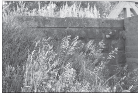
Resim 18: Demirkent Köyü/Demir Köprü Ayağı
