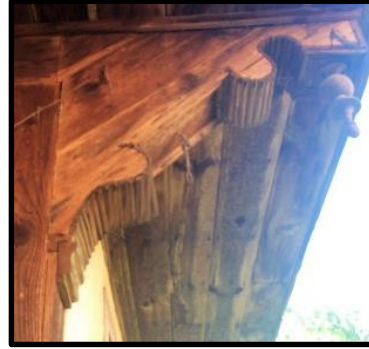
Foto 34: 3 no'lu konut konsol detayı
