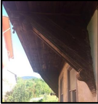
Foto 33: 3 no'lu konut konsol detayı
