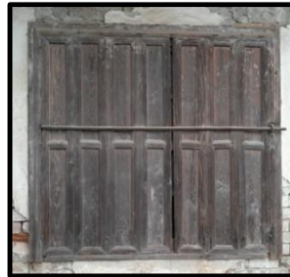
Foto 13: 11 no'lu konut pencere kepengi, Ağaköy
