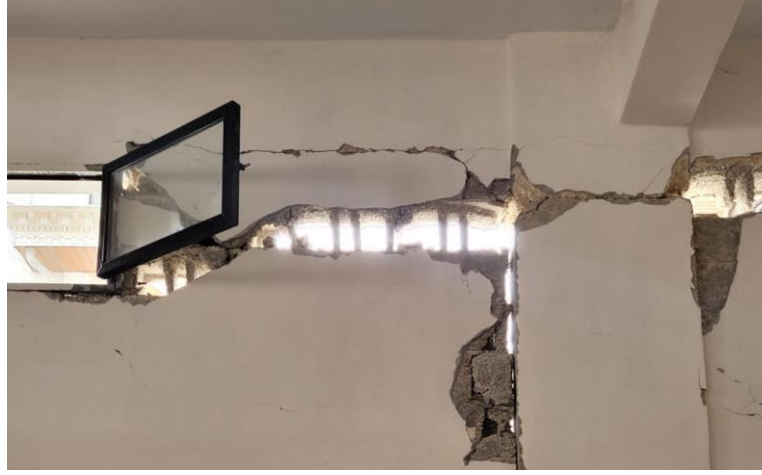
Şekil 9: Kısa kolon hasarı.
