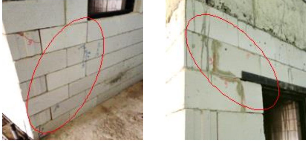
Şekil 3. İlk karakteristik hasarlar Figure 3. First characteristic cracks
