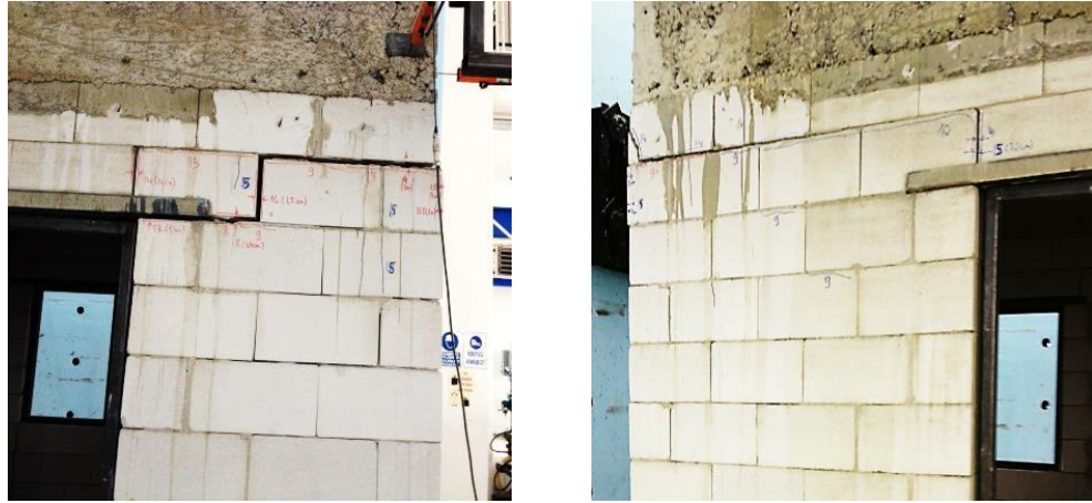
Şekil 4. Maksimum yük etkisi altında hasar durumları Figure 4. The damages under the maximum load effect
