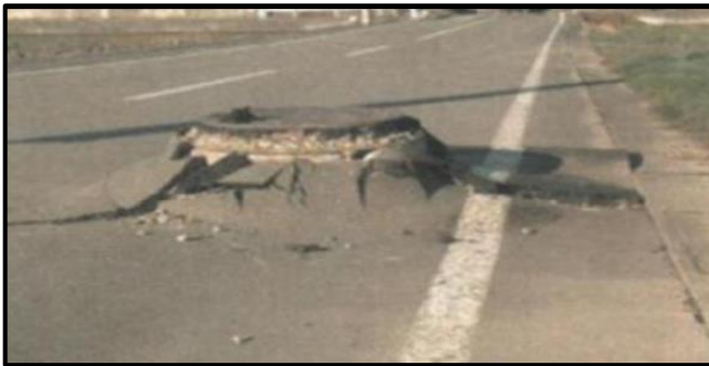
Şekil 15. Niigata (2004) depreminde sıvılaşma nedeniyle oluşan hasar (Altındış, 2020)
